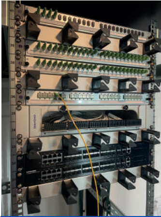
Rackansicht, mit Kabelendverschlüssen & Switches
