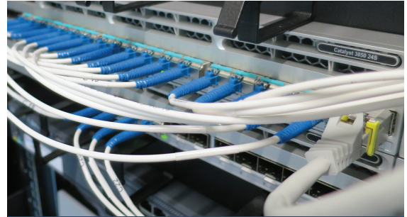
Switch Verbindung im Verteiler
